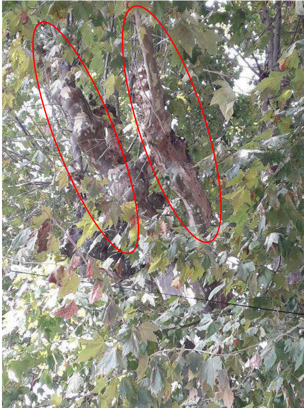
Platane commun hybride n°106 avec chancre pérennant dû au Phellin tacheté sur charpentières, les supprimer dans les meilleurs délais
